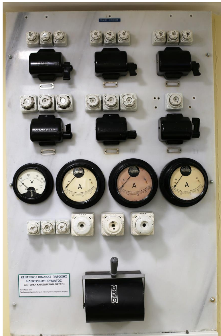
Ηλεκτρικός πίνακας – Σχολεία Ψυχικού (έτος 1936)
